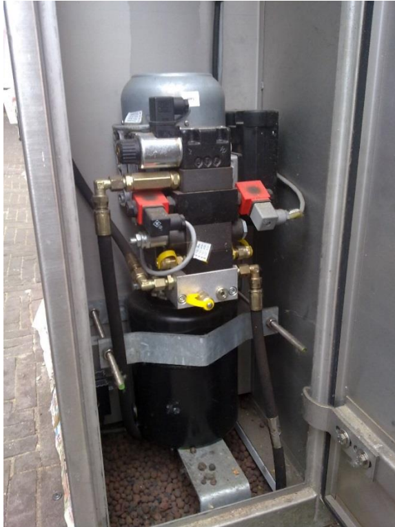
Figuur 6 Hydraulische pompunit voor centrale sturing
