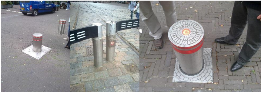
Figuur 1 Diverse installaties
