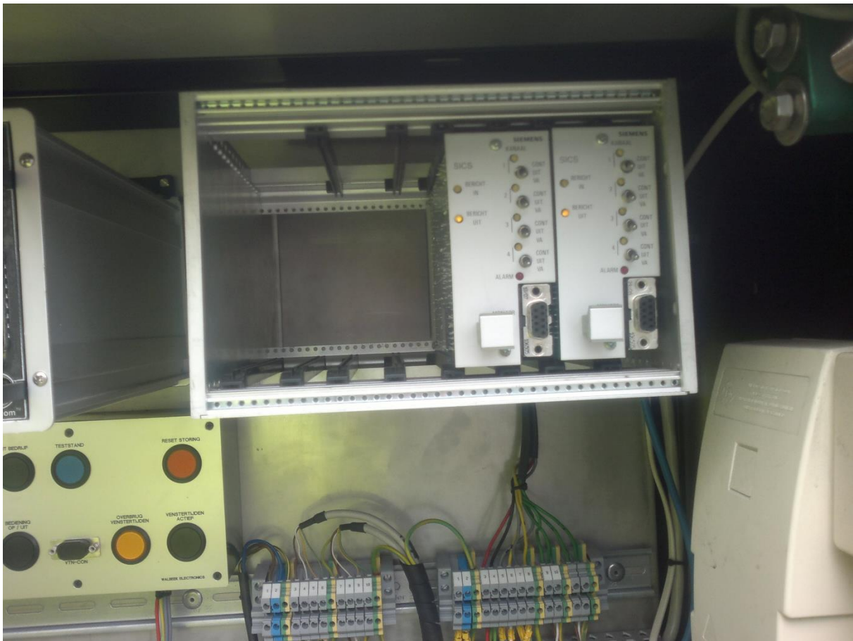
Figuur 53 Twee SICS printen in rack gemonteerd.
