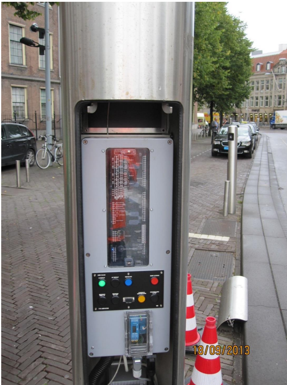
Figuur 29 Binnenkast van de master zuil met verkeersregeltoestel
