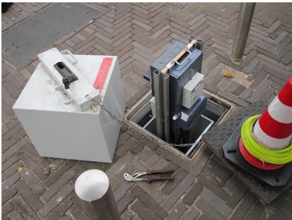
Figuur 70 De ondergrondse verdeelkast zoals in Den Haag wordt gebruikt
