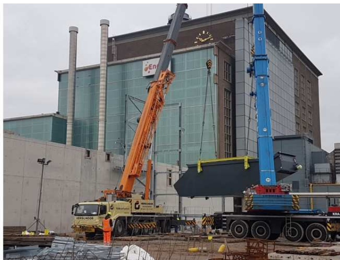
Figuur A1 9. Biowarmte Eneco Utrecht 60 MWth in aanbouw, onderdeel van een groot SV-net
