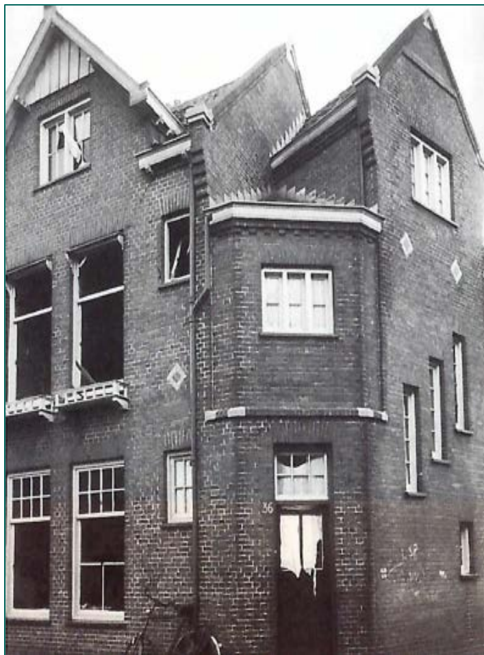
Figuur 100: Schade aan Reepstraat 36. (bron: bijlage 3, BAL, pag. 138).
