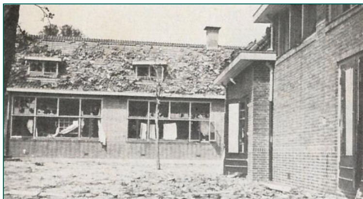
Figuur 64: Schade aan de tuinbouwschool aan de Westvlietweg. (bron: bijlage 3, HAM, pag. 14).
