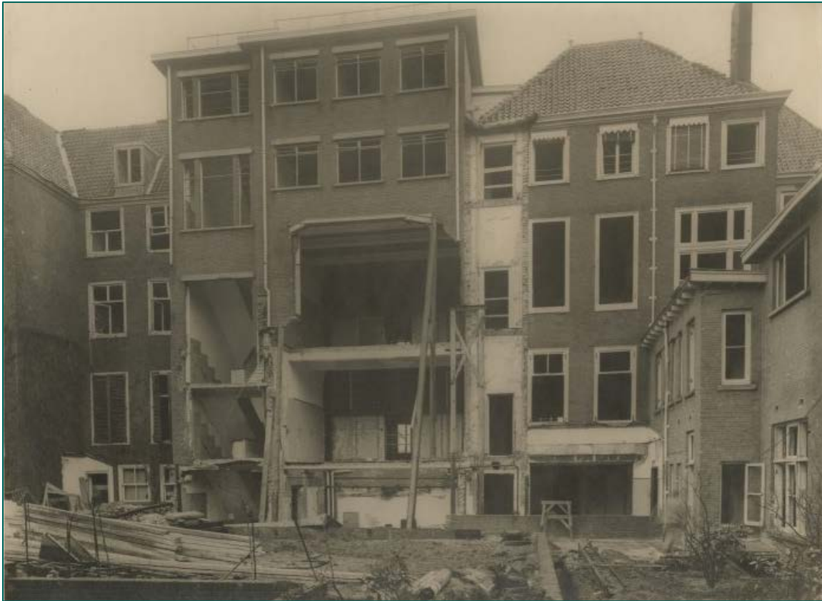
Figuur 54: Herstel van schade aan de kliniek Bethlehem na het bombardement op 10 mei 1940, 7 januari 1941. (bron: Haagse Beeldbank).
